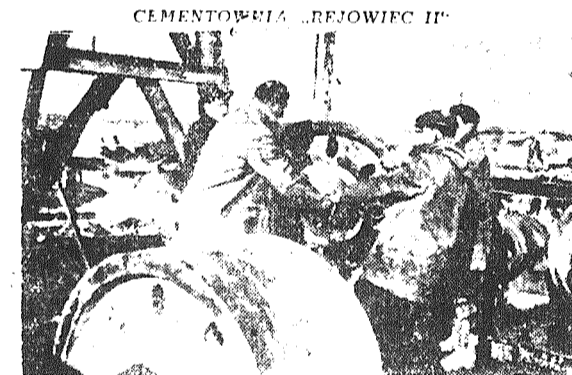
Mimo okresu zimowego tempo budowy cementowni Rejowiec nie słabnie. Na zdjęciu: Monterzy: Józef Pumera, Jan Zygfryd, Władysław Kędra i Józef Korzejak — montują łożyska pod pęd obrotowy. CAF — fot. St. Wdowiński
