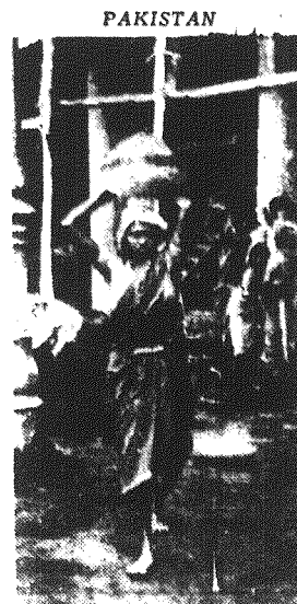
PAKISTAN. Kobiety w Pakistanie stanowią najniższą siłą roboczą. Na zdjęciu: Kobieta zatrudniona w budownictwie niesie zaprawę murarską.
