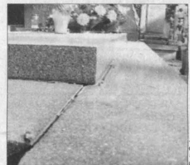
Do małych uszkodzeń wystarczy silikon
