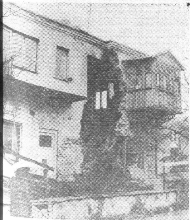
Wielka kamienica zniszczona z powodu zapadnięcia lochu.
