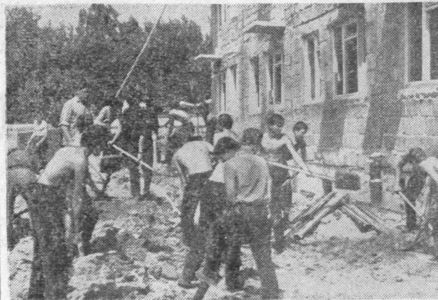
Brygada OHP z wydziału remontowego w czynnie społecznym przy pracach budowlanych wieżowca obok zakładu.
