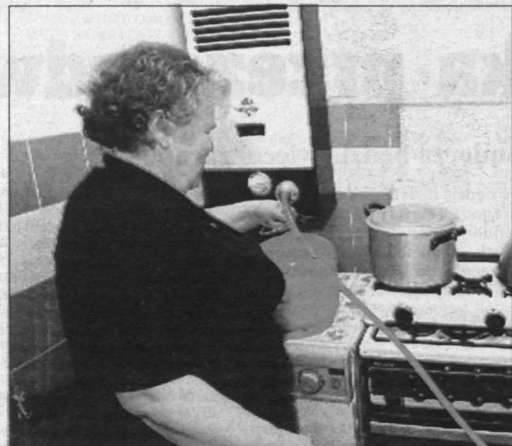
Mieszkańców bloku - w większości emerytów - nie stać na sfinansowanie remontu sieci gazowej. Na razie radzą sobie, korzystając z butli gazowych i kuchenek elektrycznych.
