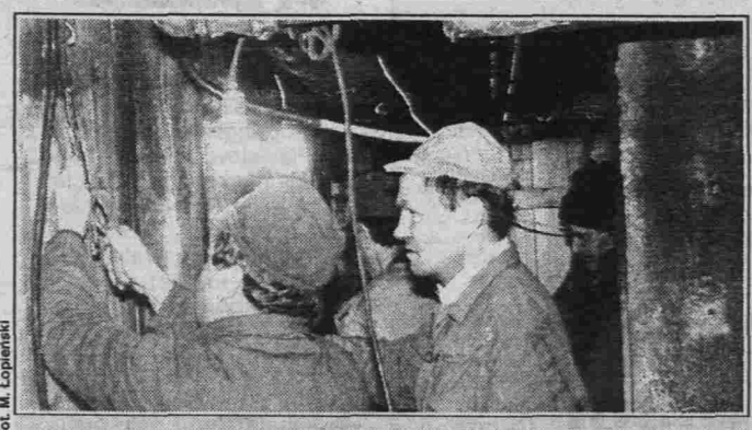
Fot. M. Lopuski Trzeba było wymieniać całą instalację elektryczną. Inne przewody, mamy nadzieję, w tym tygodniu.
