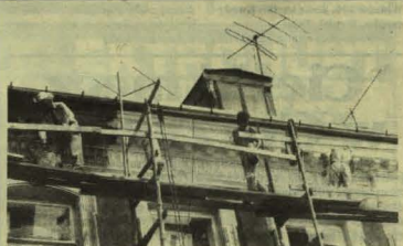
Stare kamienie przy ul. Żeromskiego w Radomiu doczekają się remontu. Fot. W. Matlok
